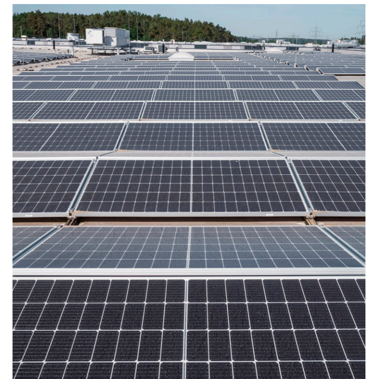
Sonnenkraft, so weit das Auge reicht: Die PV-Module füllen 60.000 m 2 Dachfläche.
