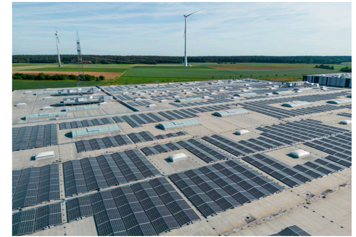
Nicht nur Windräder, auch PV-Anlagen auf vorhandenen Dachflächen können einen wertvollen und nahezu unsichtbaren Beitrag zur Energiewende leisten.
